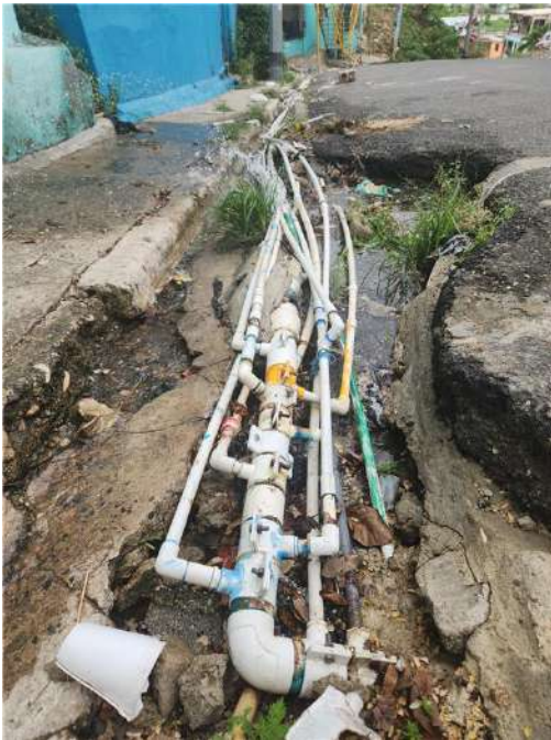
Figura 18: Conexión ilegal a la red de agua. Fuente : Groupe Huit
