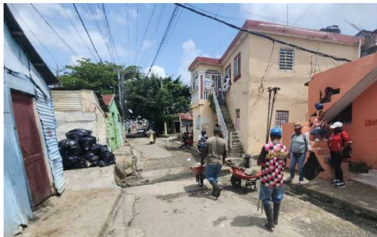
Figura 29 : Foto de un equipo del Ayuntamiento retirando desechos sólidos de un pluvial para destaparlo. Fuente: propia
