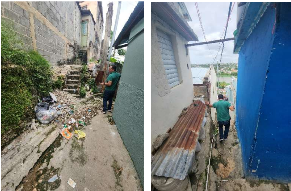
Figura 19 : Fotos de zonas sin drenajes pluviales, donde el agua corre por las pendientes y escaleras durante los eventos de lluvia (se observan claramente las marcas de escorrentía). Fuente: propia
