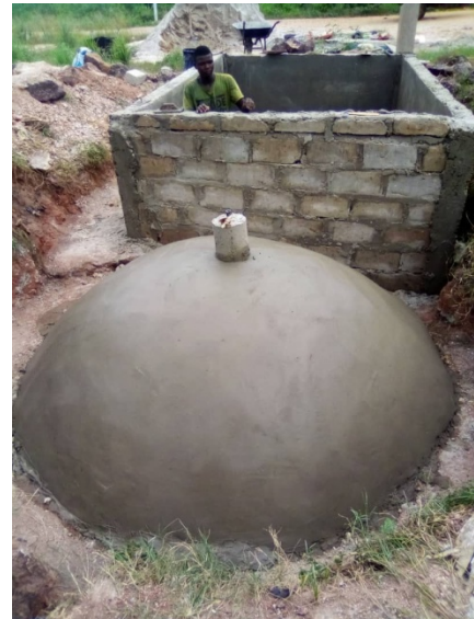
Figura 36: Biodigestor de residuos orgánicos (Fuente: Empresa SEWA)
